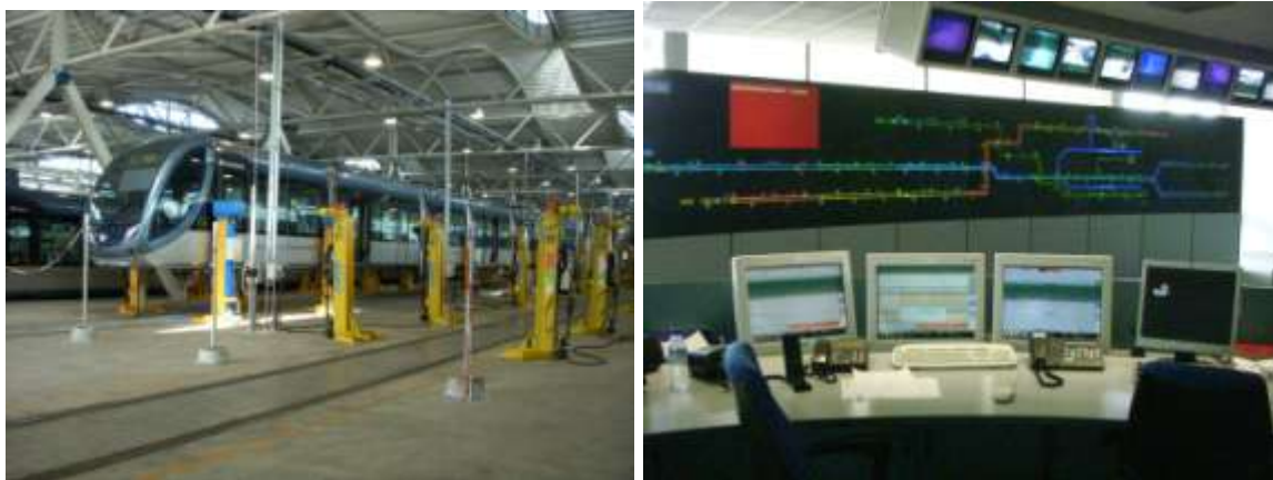
Figura 126: Exemplu de facilități moderne într-un depou cu ateliere de întreținere și Centru de control în Bordeaux, Franța (Sursa: TTK)
